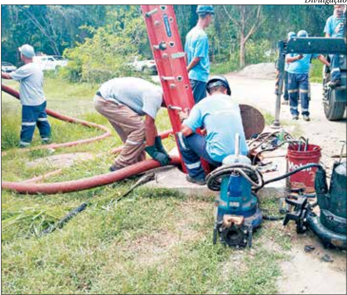
Funcionários da Águas de Niterói redirecionaram o lançamento de esgoto
