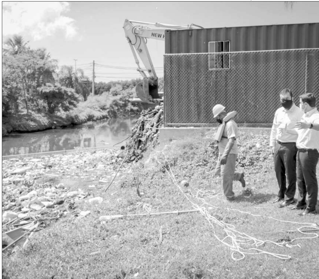
O governador em exercício Cláudio Castro acompanhou a instalação das estruturas nos rios Arroio Pavuna e Pavuninha
