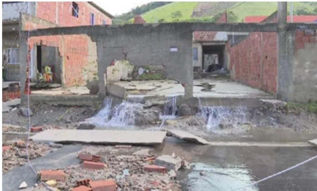
Rompimento de adutora causa destruição em Nova Iguaçu
